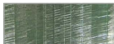
Conventionnel – Marques de vibration
